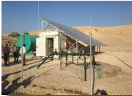
Abwasserwiederverwertung zur Grundwasseranreicherung und Bewässerung in Fuheis, Unteres Jordantal, Jordanien © Martin Sauter
